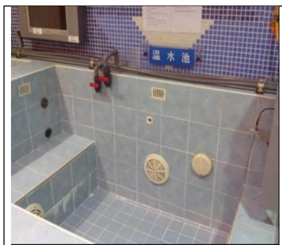
圖 3-7 實驗之浸泡溫泉池
